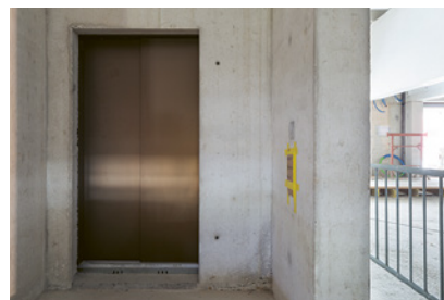
3 La porte de l'ascenseur protège contre le risque de chute.
