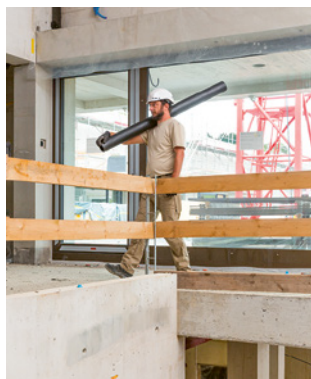
Règle 2 Sécuriser les endroits non protégés à partir de 2 m de hauteur
