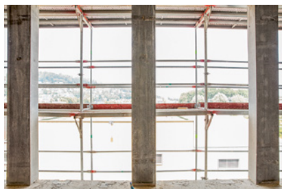
1 L'échafaudage de façade empêche de tomber par l'ouverture de la fenêtre ouverte.
