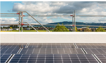
1 Échafaudage de façade servant de protection contre les chutes
