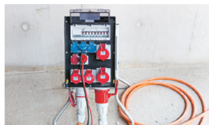
3 Tableau électrique de chantier avec DDR
