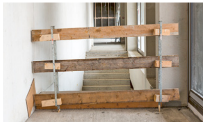
2 Garde-corps utilisé pour sécuriser une zone à risque de chute
