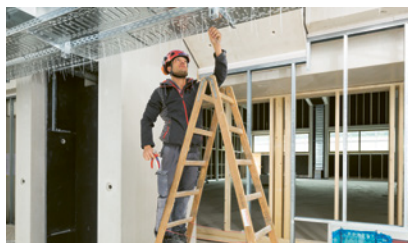
2 Échelle double sans plateforme de sécurité
