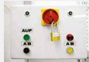
Arrêter et sécuriser l'installation
