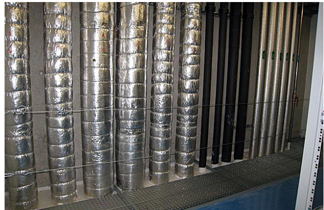
1 Durchbruchssichere Brandabschottung. Gitterrost über der Brandabschottung
