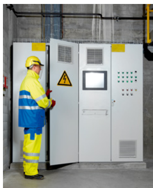
Regola 6 Solo professionisti per i lavori elettrici
