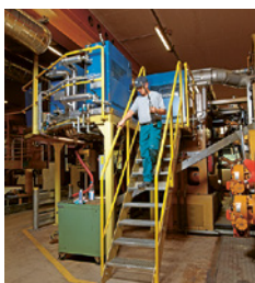
1 Piattaforma di lavoro fissa con parapetto
