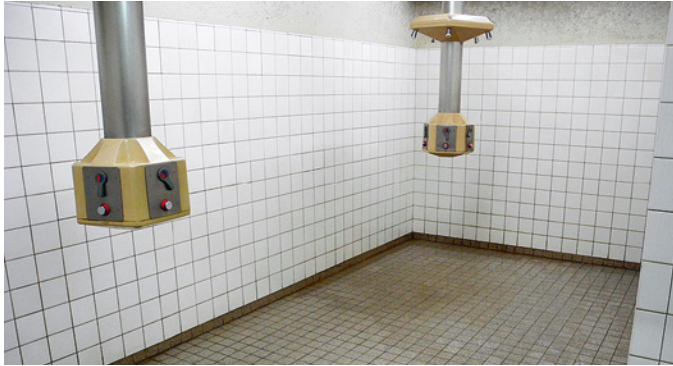
Platten am Boden und an den Wänden mit asbesthaltigem Kleber
