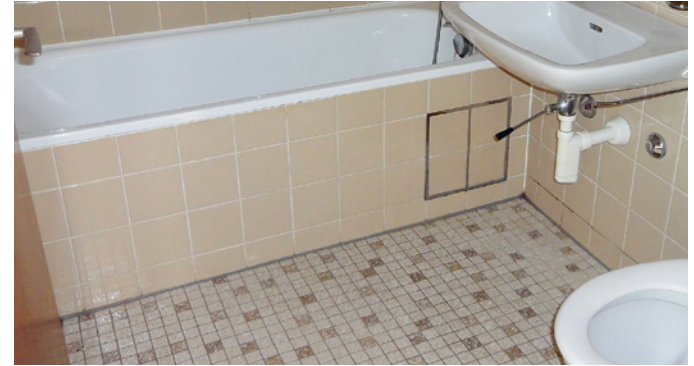
Platten mit asbesthaltigem Kleber
