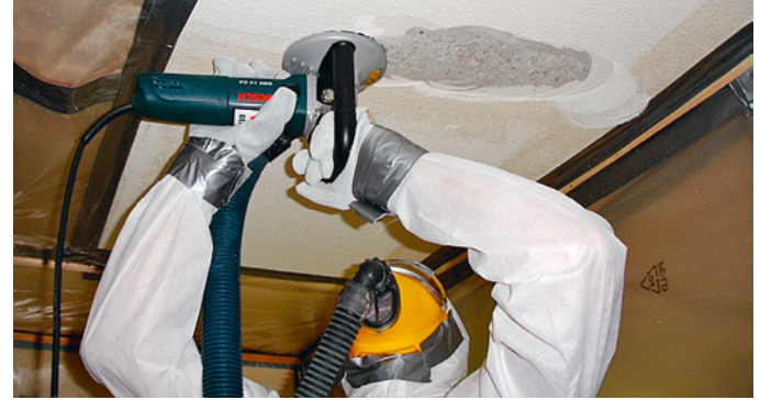
Entfernen nur durch anerkannte Asbestsanierungsfirmen
