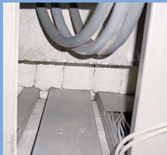
Brandabschottung mit Asbestkissen
