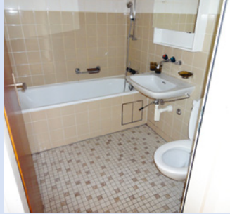
Asbesthaltiger Kleber hinter den Platten
