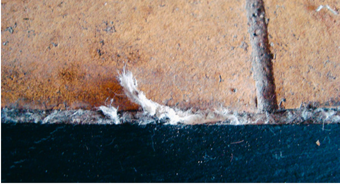
Asbestschnüre in einem Cheminée
