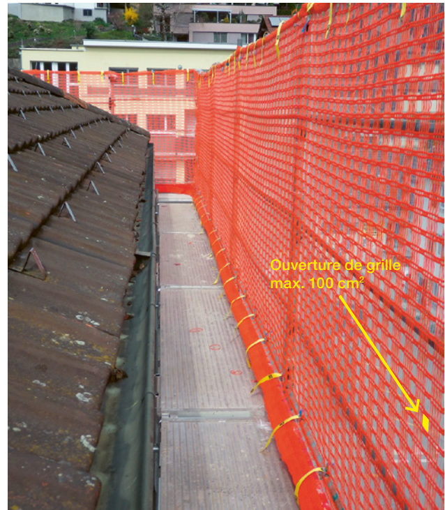
1 Exemple de système de paroi de protection de couvreur conforme aux prescriptions de l'art. 59 OTConst et testé selon la norme SN EN 13374, réalisé avec des filets de protection fixés avec des sangles d'arrimage.
