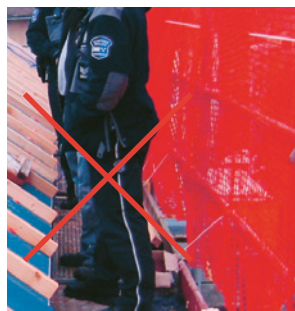
5 La police et les autorités chargées de l'enquête établissent la cause de l'accident (paroi de protection de couvreur non conforme fixée avec des colliers de serrage en plastique).
