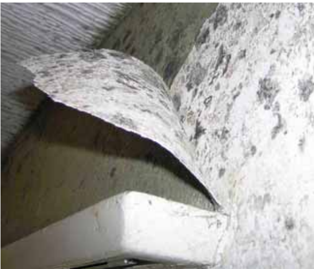
Figure 2: Contamination par des moisissures sur le et le crépi se trouvant en dessous (contamination des couches sous-jacentes).
