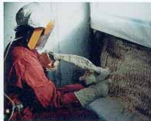
Ausschäumen eines Hohlrums mit Polyurethanschaum. Die Schutzausrüstung schützt die arbeitende Person unter anderem vor den Asthma-verursachenden Isocyanatdämpfen.
