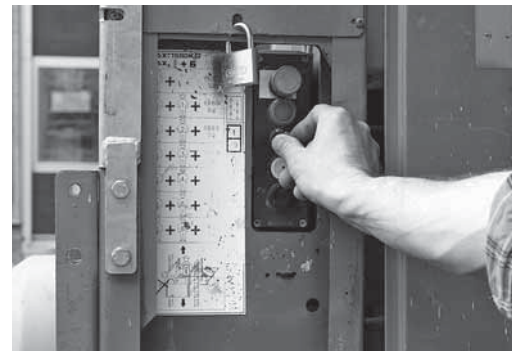
Fig. 5: pannello di comando sulla piattaforma
