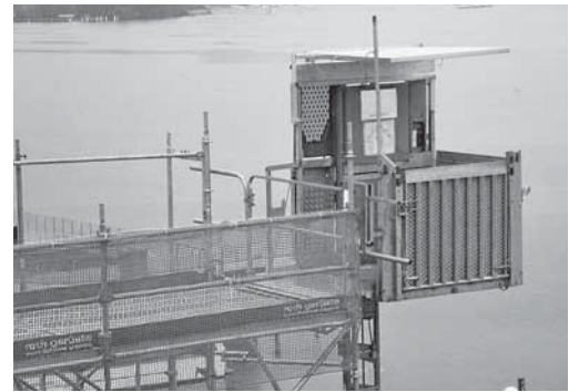
Fig. 4: accesso sicuro alla piattaforma di un montacarichi da cantiere
