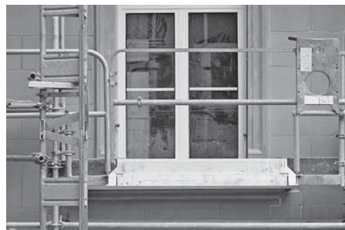
Fig. 1: punto di carico/scarico con barriera
