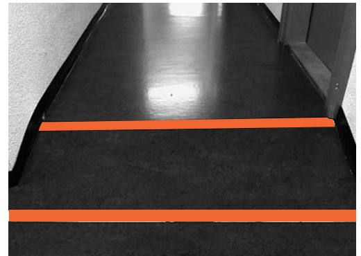
Bild 1: Stolperstellen, z. B. Schwellen deutlich markieren.
