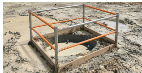
6 Offene Bohrlöcher sind mit einer unverrückbaren und tragfähigen Abdeckung oder mit einem mobilen Seitenschutz zu sichern.
