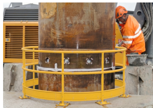
5 Beim Zusammenfügen von Ausrüstungsteilen ist der Mitarbeitende absturzgefährdet, wenn z. B. kein Seitenschutz vorhanden ist.
