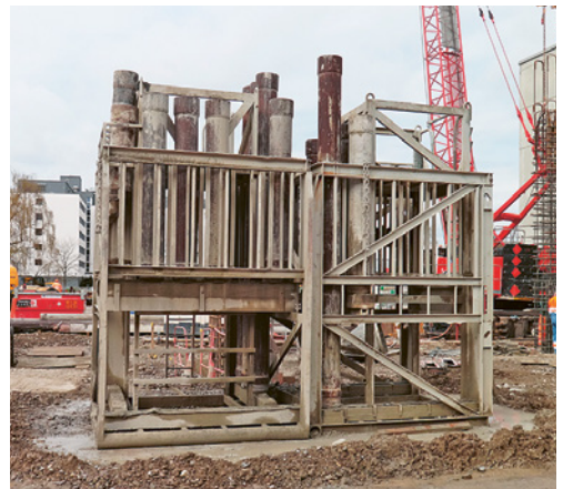
2 Vorbildliche Lagerung von Schüttröhren.
