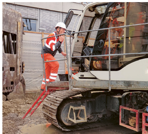
5 Richtiges Auf- und Absteigen von Baumaschinen trägt viel zur Unfallverhütung bei.
