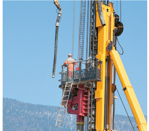
1 Unterhaltsarbeiten können vom einem Arbeitskorb aus erfolgen.
