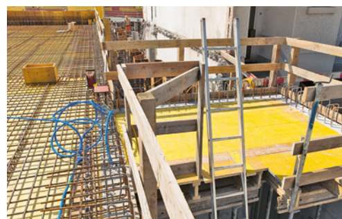
8 Cette échelle dépasse d'au moins 1 m le point d'appui supérieur et des garde-corps permettent de la quitter en toute sécurité.
