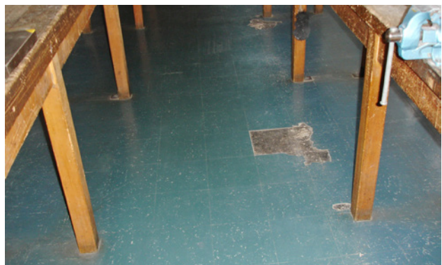
1 Revêtements floor flex monocouches. Les fibres d'amiante sont intimement liées à la matrice.
