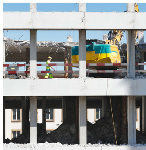
5 Les zones présentant un risque de chute sont sécurisées par un garde-corps périphérique.
