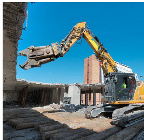
2 En cas de démolition mécanique, personne ne doit se trouver dans la zone dangereuse.
