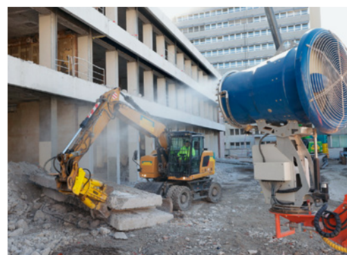
6 Réduire le dégagement de poussière par des mesures appropriées, p. ex. brumisation au niveau de l'engin de démolition, humidification avec de l'eau.
