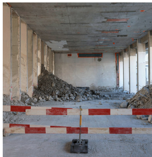
3 L'accès à la zone dangereuse est condamné par une barrière de protection.
