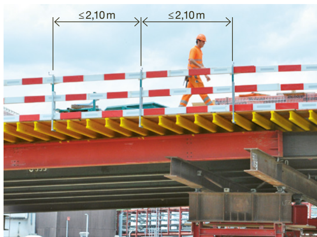
1 Garde-corps périphérique avec lattes de barrage rouges et blanches. Écartement maximal entre les montants: 2,10 m.
