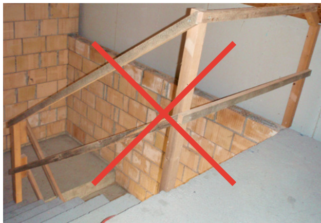
2 L'utilisation de lattes de toit comme main courante dans une cage d'escalier est interdite.
