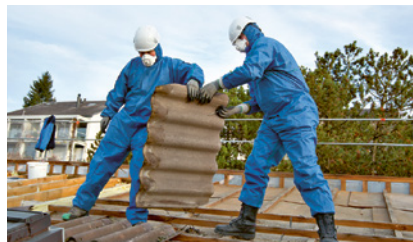
1 Lors des travaux de démontage, les plaques de fibrociment contenant de l'amiante doivent être laissées en l'état.
