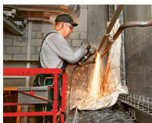
1 Protection des conduites électriques
