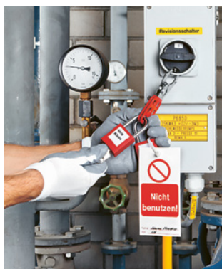
Règle 5 Arrêter et sécuriser les installations.
