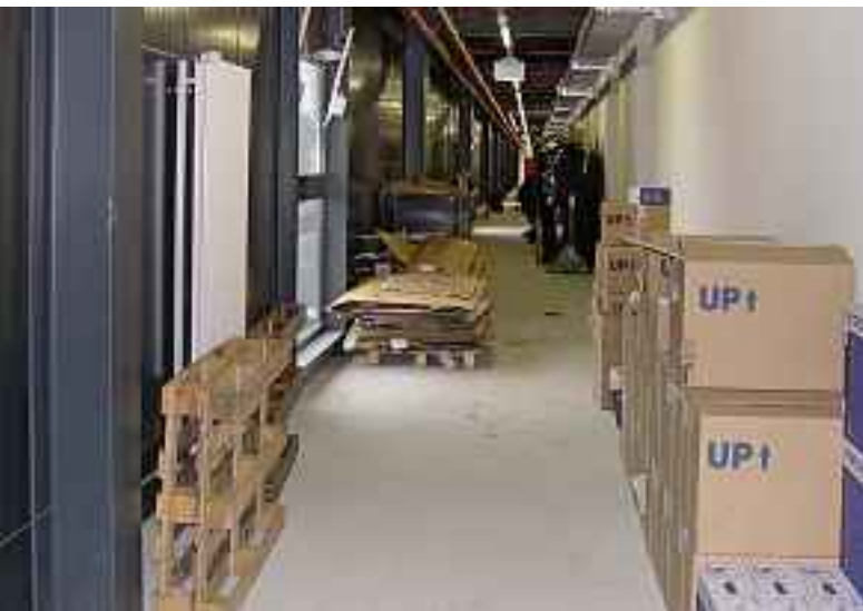
In vielen Betrieben ein Problem: Als Lager genutzte und verstellte Verkehrs- und Fluchtwege können schlimme Stolperunfälle nach sich ziehen und im Brandfall zur tödlichen Falle werden.
