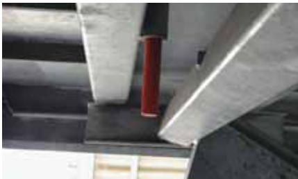
02 // Die Sicherheitsbolzen blockieren die Quervertraverse auf der Unterseite der Plattform. Dadurch kann sich die Plattform nicht absenken.
