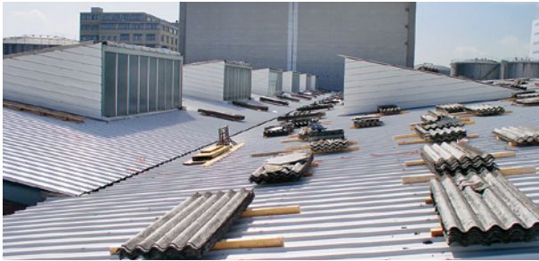
Lastre ondulate contenenti amianto
