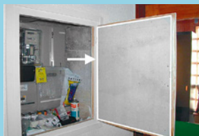
Pannello antincendio contenente amianto
