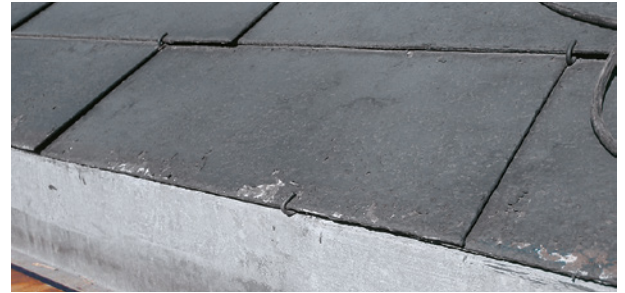
Pannelli di ardesia contenenti amianto
