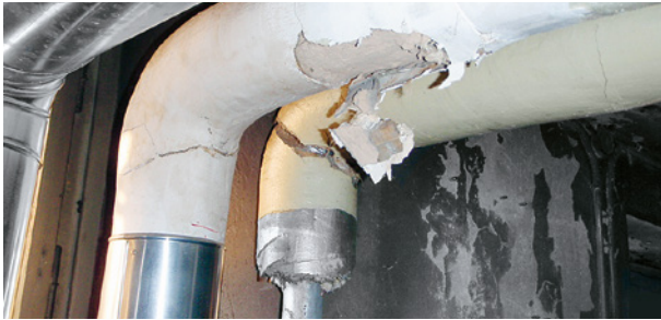
Tubo con malta contenente amianto
