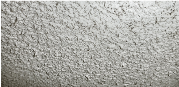
Intonaco fonoassorbente contenente amianto
