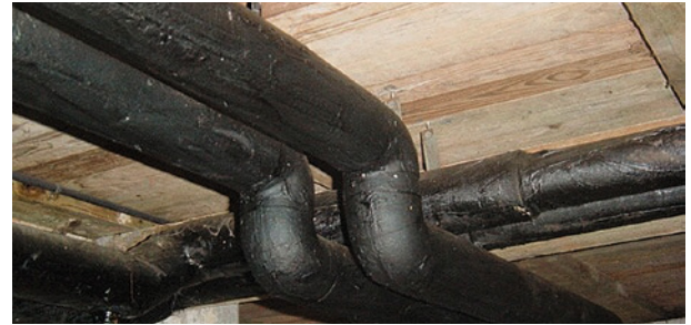
Tubi con guaina bituminosa contenenti amianto
