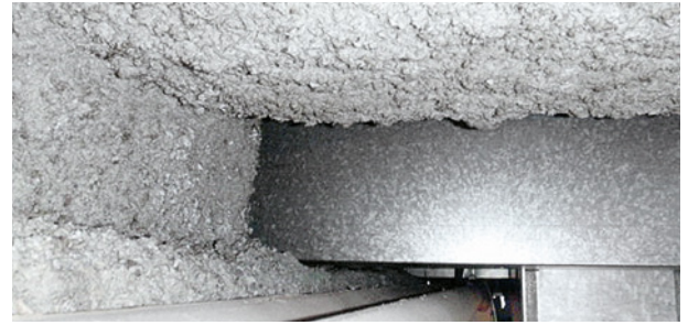
Amianto spruzzato come rivestimento antincendio su travi di acciaio
