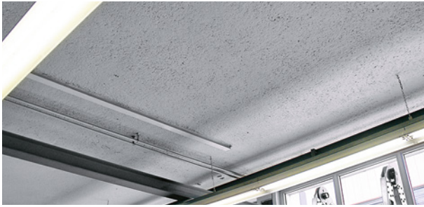
Rivestimento del soffitto in amianto spruzzato
