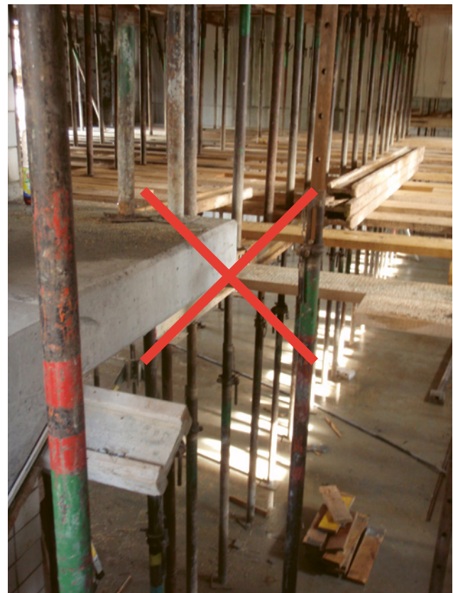
1 Solche Zwischenböden sind verboten. Die Arbeiten müssen eingestellt werden.
