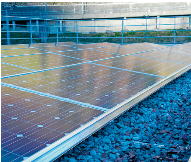
5 Installation solaire sur un toit plat avec garde-corps permanent sur le pourtour
