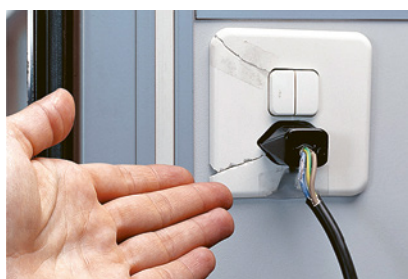
2 Piastra di copertura danneggiata e cavo difettoso, rischio di elettrocuzione.
