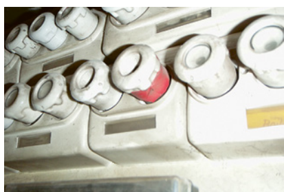
1 Elemento in ceramica difettoso, rischio di elettrocuzione.
