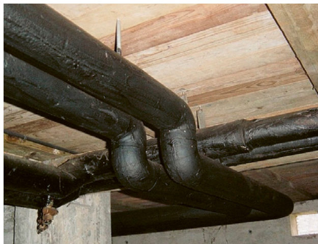
2 Guaina bituminosa contenente amianto
