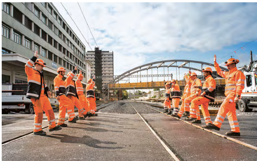
Sur le chantier de Berne Wylerfeld, les travailleurs entraînent leur équilibre au moyen du footbag. // Raffael Waldner
