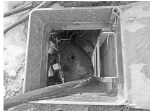
Bild 2: Für den Zugang zum Schacht ist eine Leiter fest installiert.
