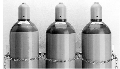
1 Sicherung der Druckgasflaschen mit Ketten
