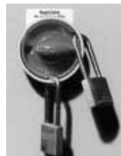
Figura 9: durante i lavori di manutenzione ogni montatore/manutentore deve avere a disposizione un lucchetto personale per poter chiudere l'interruttore di sicurezza dell'impianto.
