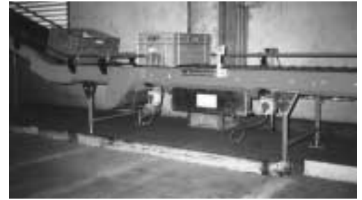
Figura 1: per poter verificare la presenza e lo stato dei dispositivi di sicurezza è necessario avere a disposizione un elenco completo degli stessi.
