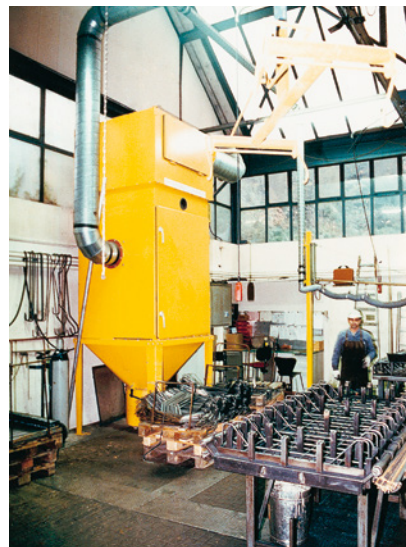
Bild 38 Zentralentstaubungs- anlage für Schweisss- rauch und Schleif- staub
