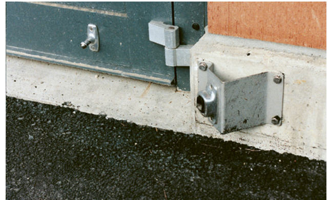
23 Die Windsicherung dieser Türe bildet keine Stolperstelle, da sie an der Wand angeordnet ist.
