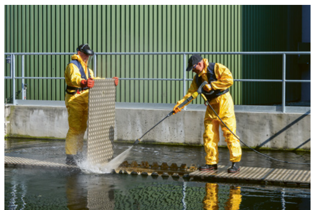
33 Sicherung durch Rettungswesten bei Arbeiten ausserhalb der Geländer und bei gefüllten Becken.
