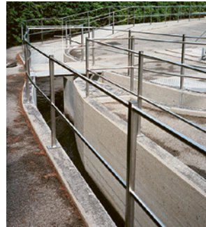
14 Geländer entlang der Sturzkanten zur Sicherung offener Kanäle.
