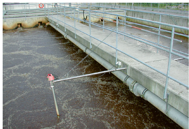
35 Die Messsonden des Belüftungsbeckens können zum Beispiel mit einer Kette zum Geländer am Beckenrand hochgezogen und so ohne Gefährdung kontrolliert und gereinigt werden.
