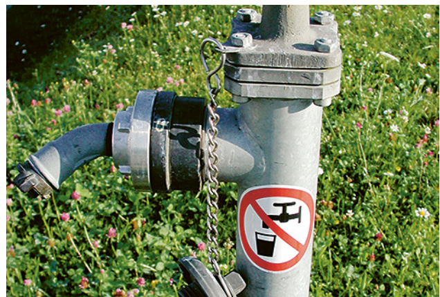
36 Kennzeichen für kein Trinkwasser
