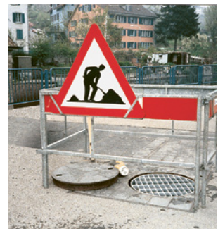
18 Mobile Abschränkungen zum Sichern von Bodenöffnungen sind immer vor dem Öffnen aufzustellen.
