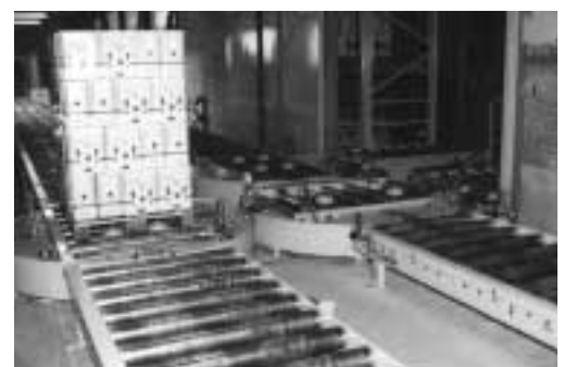
Figure 5: installation avec tables tournantes équipées de protections locales.
