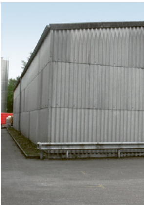
1 Mit asbesthaltigen Platten verkleidete Fassade
