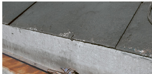
Pannelli di ardesia contenenti amianto
