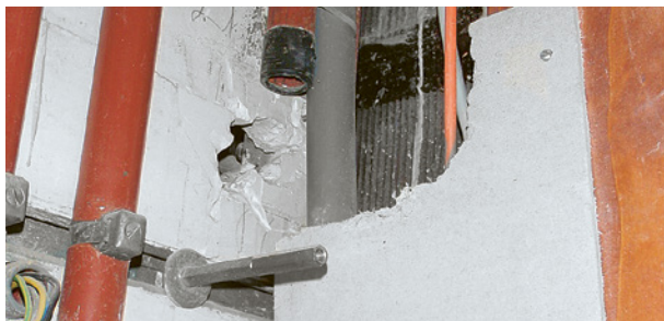
Pannello antincendio in un vano tecnico
