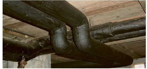
Guaina bituminosa contenente amianto
