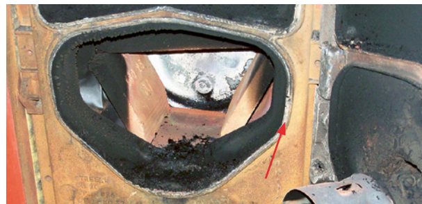
Cordone di amianto
