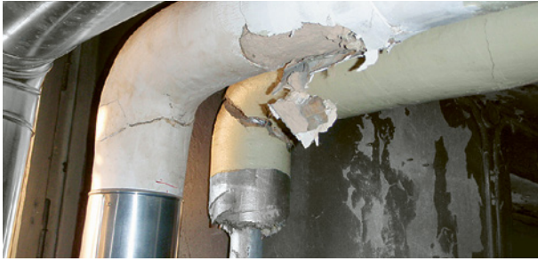
Tubo con malta contenente amianto
