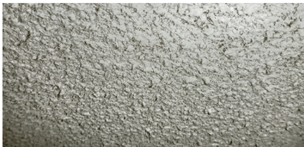
Intonaco fonoassorbente contenente amianto
