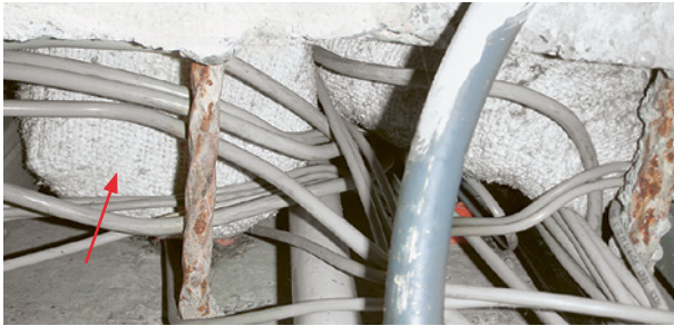
Cuscini antifiamma contenenti amianto
