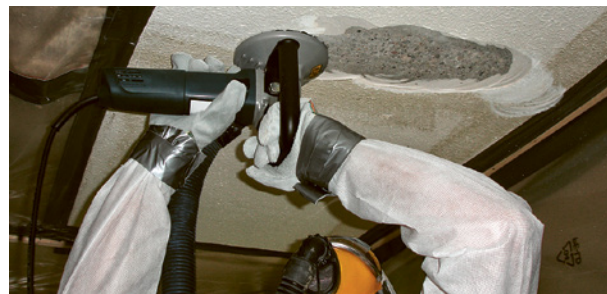
Rimozione solo da parte di ditte specializzate in bonifiche da amianto riconosciute
