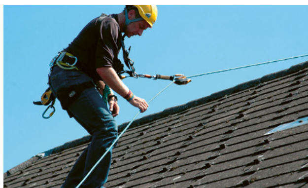
3 Una semplice ispezione comporta di per sé un rischio di caduta dall'alto o per sfondamento del tetto. Anche in questo caso è indispensabile garantire la messa in sicurezza a regola d'arte!
