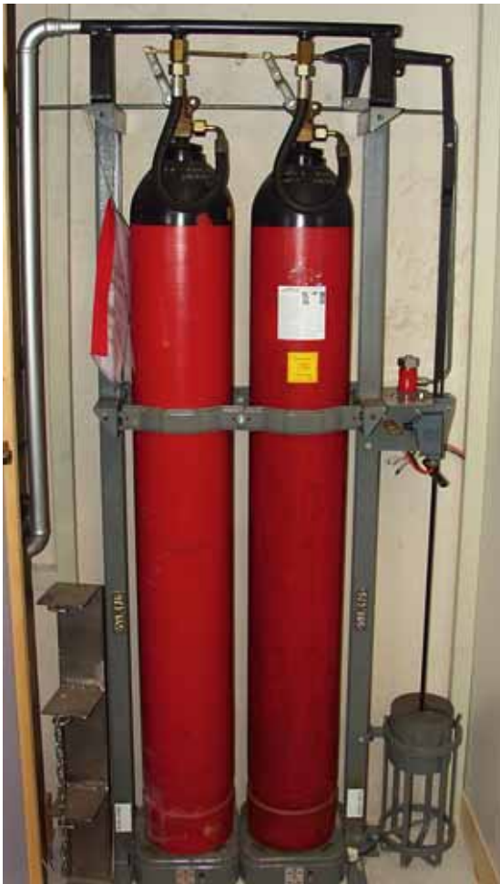
Bild 7: Poste fixe d'extinction au CO 2
