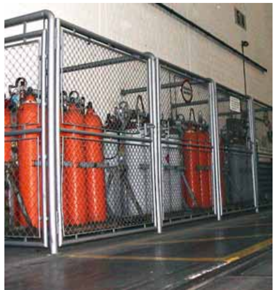
Fig. 21 Bouteilles à gaz raccordées dans une halle d'usine
