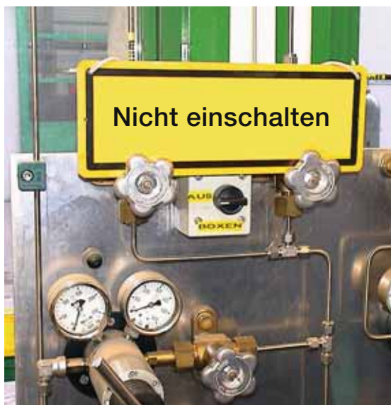
Fig. 25 Signalement d'une installation non opérationnelle
