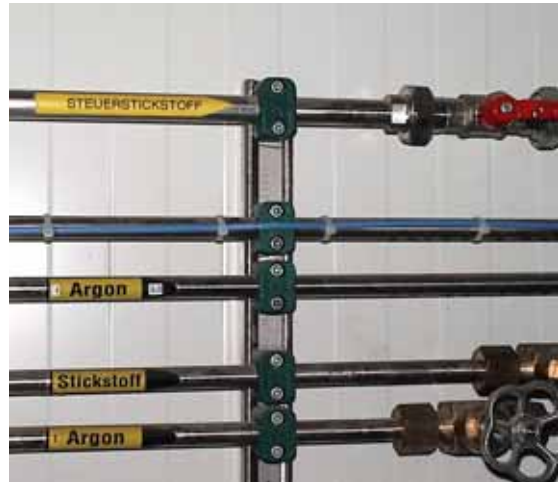
Fig. 9 Identification des conduites
