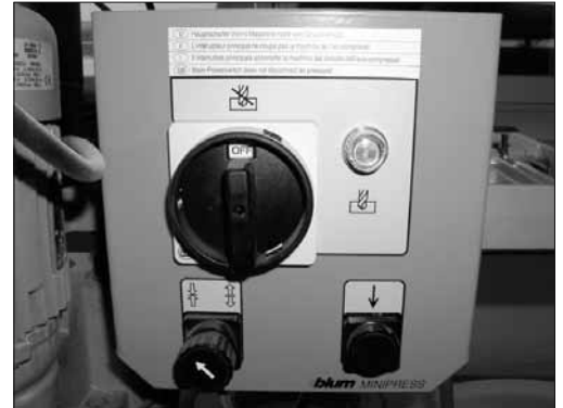
Figure 1: l'interrupteur de sécurité coupe l'amenée d'énergie aux éléments mobiles.
