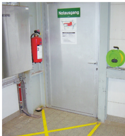
3 Dégager les sorties de secours.
