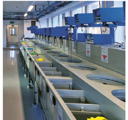
9 Impianto di aspirazione
