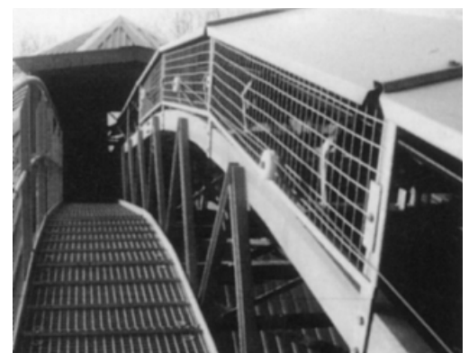
Figure 6: grillage vissé protégeant une zone de passage à proximité d'une déviation de la bande. L'extrémité du grillage doit recouvrir les zones dangereuses!
