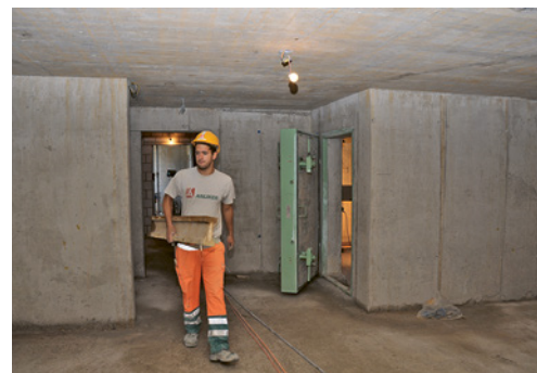
8 Pendant les travaux de gros œuvre, l'intérieur de l'ouvrage doit être correctement éclairé.
