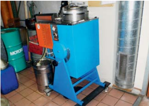
29 Installation de distillation pour liquides inflammables
