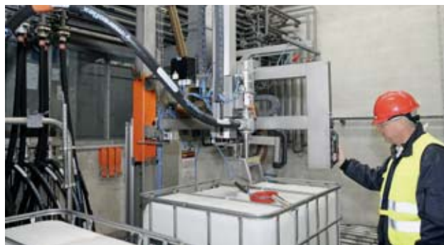
18 Station d'enfûtage semi-automatique équipée d'un système de captage des vapeurs à la source
