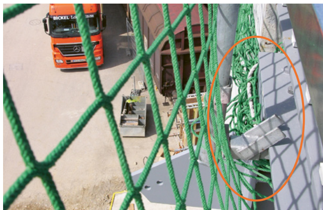
3 La rete di sicurezza verticale deve essere fissata in modo tale che sotto carico non si formino delle aperture superiori a 30 cm.
