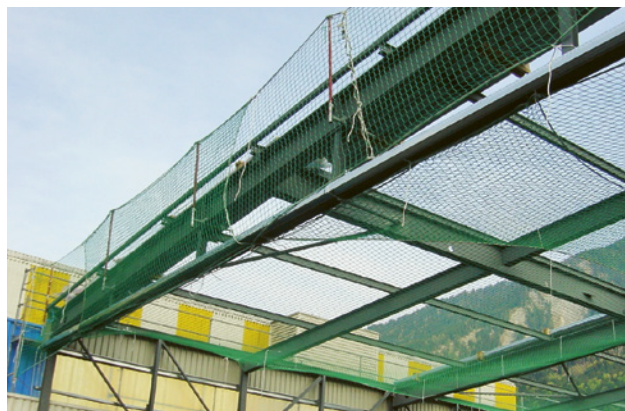
4 In questa costruzione industriale la rete di sicurezza funge da protezione lungo il perimetro del tetto.
