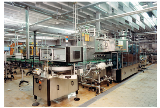
5 Baffeln aus Steinwolle-Akustikplatten in einer Getränkefirma (Abfüllanlage).
