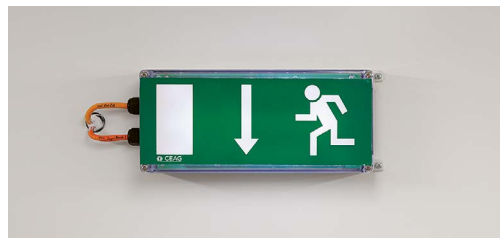
4 Eclairage de secours (électrique)
