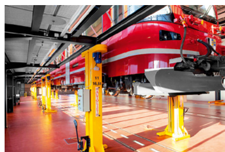
12 Hebebock-Anlage mit beschrifteter Tragfähigkeit 16,5 t
