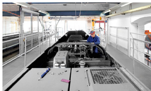
8 Arbeiten am Stromabnehmer auf dem Fahrzeugdach: Der Laufsteg ist mit herausnehmbaren Geländern versehen.
