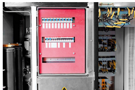
15 Isolierende Abdeckungen verhindern ein direktes Berühren bei geöffneter Schranktür.
