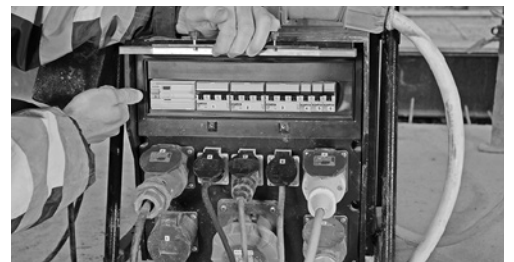
7 Coffret de chantier équipé d'un DDR: contrôler le fonctionnement selon la notice d'instructions avant chaque intervention.
