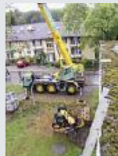
«Une chargeuse sur pneus bascule par-dessus le bord d'un toit.» Exemple sur www.suva.ch/exemples-accidents
