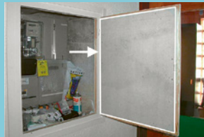
Pannello antincendio contenente amianto
