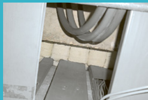
Barriera antifiama con cuscini di amianto
