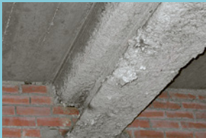
Isolamento in amianto spruzzato
