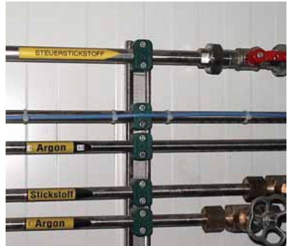
Bild 9: Kennzeichnung von Rohrleitungen
