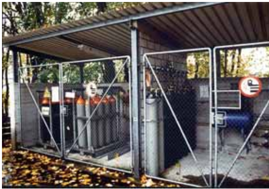
Bild 20: Durch eine Wand getrennte Aufstellung
