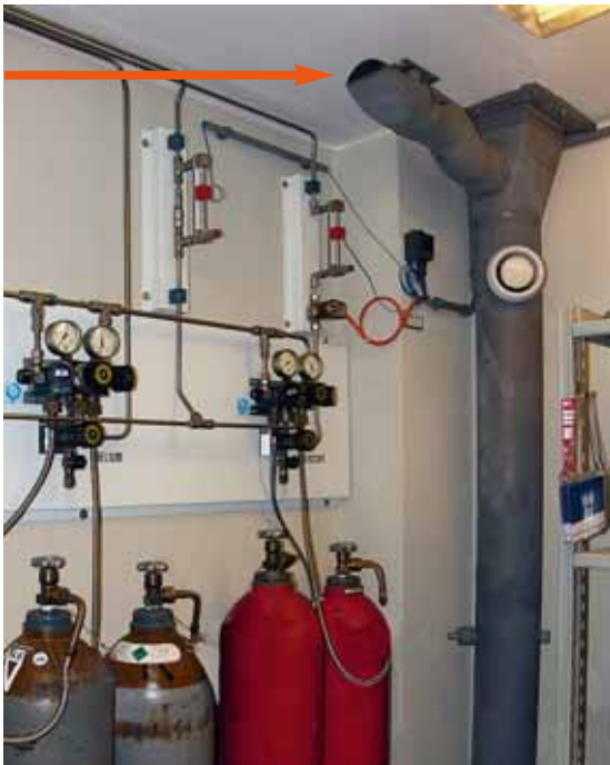
Bild 19: Absaugung unter der Decke
