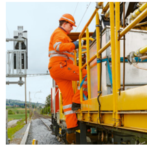
3 Travailleur debout sur un véhicule situé sous des caténaires
