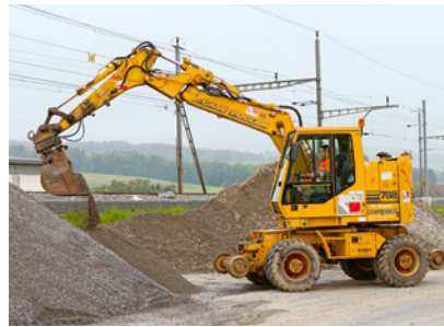
2 Machine de chantier à proximité d'une caténaire
